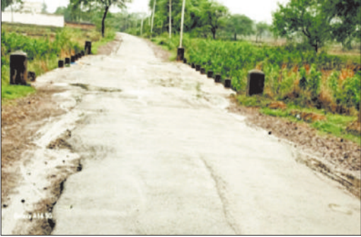
जर्जर हालत में जमड़ीनाला।
